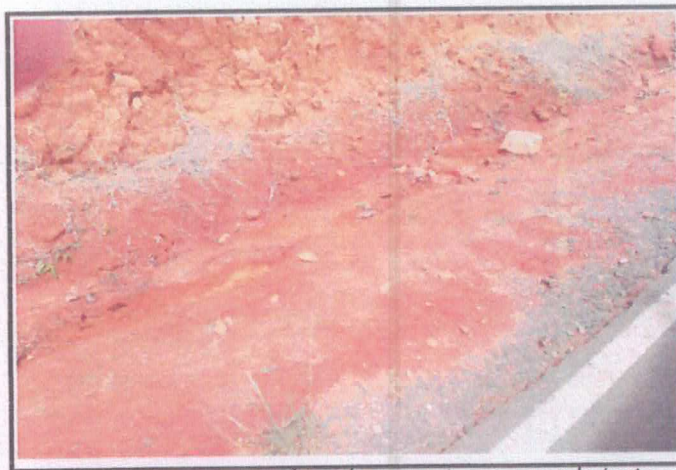
Foto 04 - Observar-se a água de nascente escorrendo junto a pista de rolamento.
