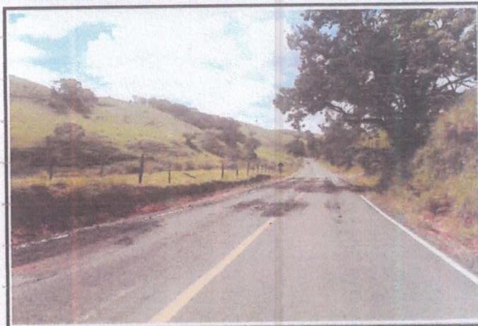
Foto 06 - Pista danificada com trincas tipo "jacaré" e trincas tipo "bloco"
