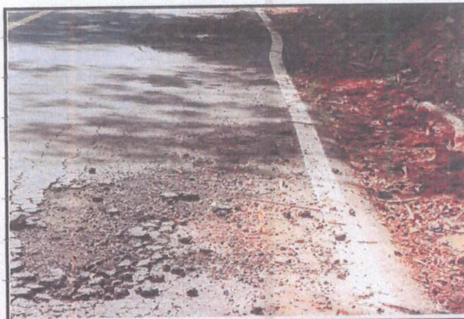
Foto 08 - Pista danificada com trincas tipo "jacaré" e trincas tipo "bloco"
