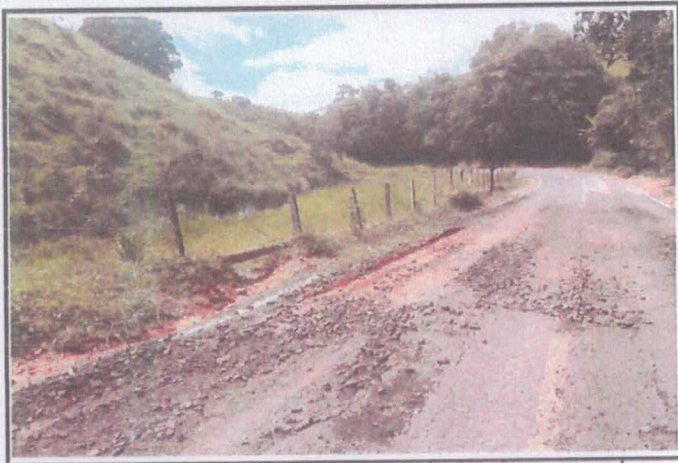
Foto 01 - Deterioramento da camada CBUQ a esquerda presença do córrego.
