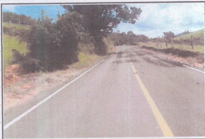
Foto 05 - Pista danificada com trincas tipo "jacaré" e trincas tipo "bloco"
