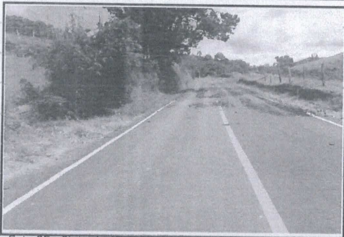
Foto 05 - Pista danificada com trincas tipo "jacaré" e trincas tipo "bloco"
