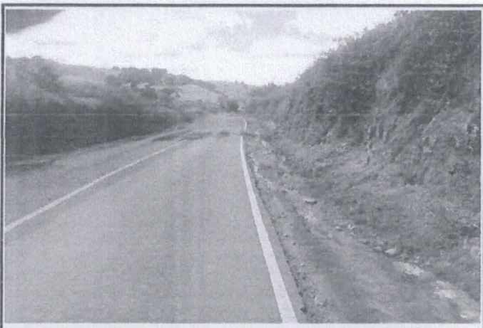
Foto 03 - Observar-se a água de nascente escorrendo junto a pista de rolamento danificada.
