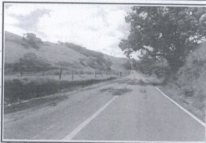
Foto 06 - Pista danificada com trincas tipo "jacaré" e trincas tipo "bloco"
