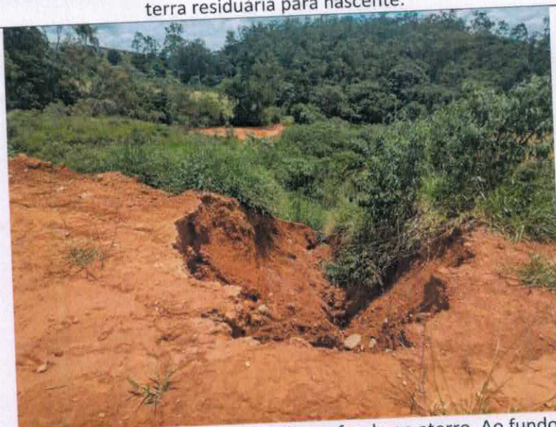
Canal construído no aterro para escoamento de água pluvial e que contribuiu para o carreamento de terra residuária para nascente.
