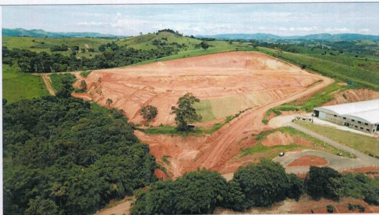
Estrias de erosões profundas nos taludes
