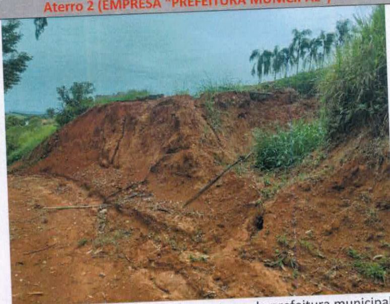
Exemplar de erosão profunda no aterro da prefeitura municipal.
